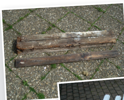
So sahen die Teile nach dem Ausbau aus.
